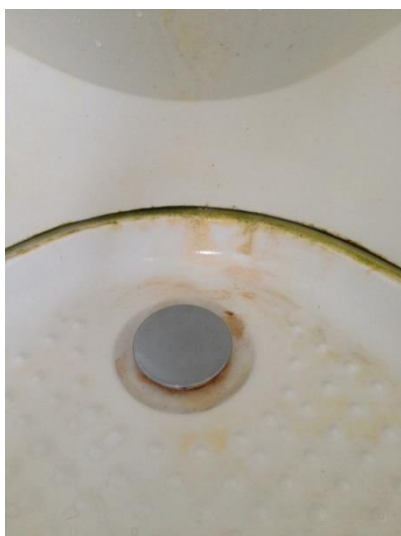
Før rengøring (fladesnavs) på et ikke afgrænset område
