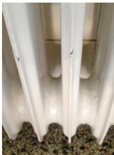
Støv på radiator
