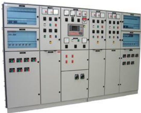
Eltavle fra ”større” bygning/virksomhed
