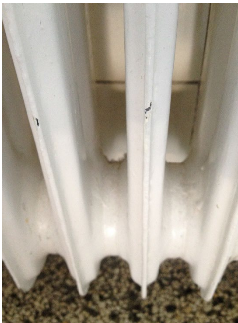
Støv på radiator
